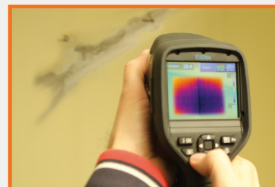
Température relevée par caméra thermique
