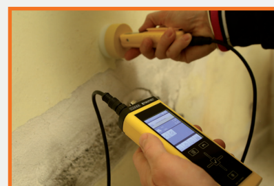
Relevé avec un hygromètre numérique dans un local enterré présentant des infiltrations
