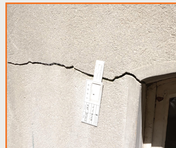
Fissure engendrée par le lessivage du sol d'assise
