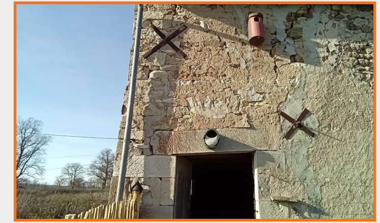
Les désordres persistaient après la pose de tirants métalliques
