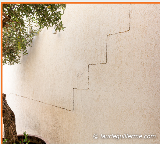
Fissure en escalier en façade
