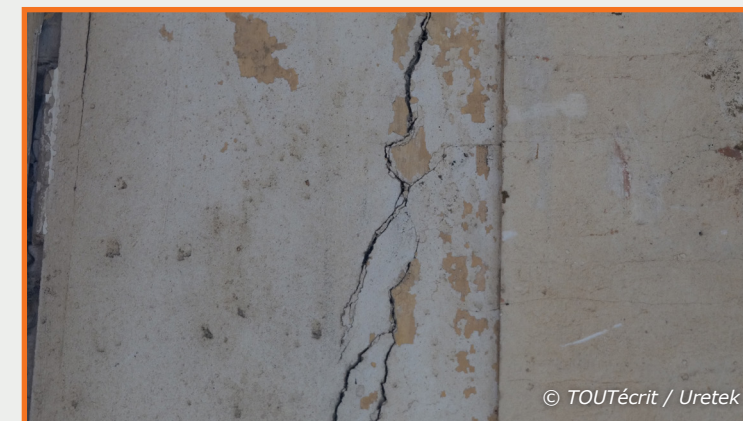
Fissures résultant des tassements différentiels
