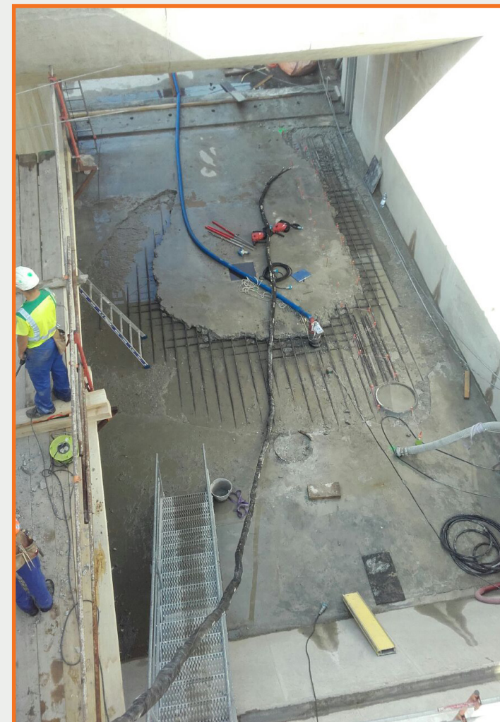
Venues d'eau arrivant par la sous-face du radier à travers des fissurations
