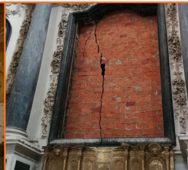
Fissures visibles à l'intérieur de la chapelle
