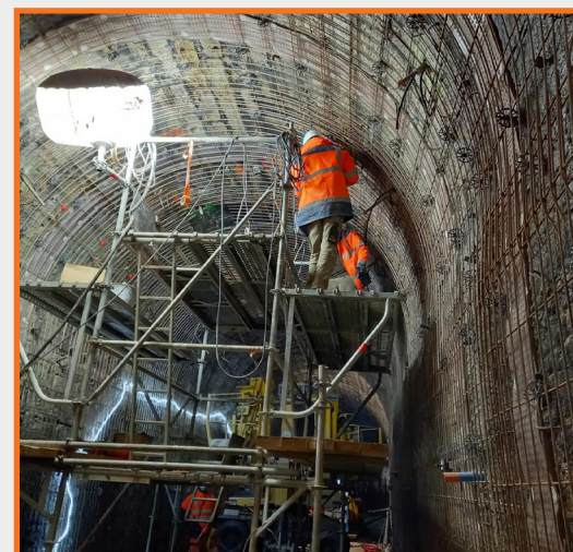
Injections effectuées en ciel de voûte
