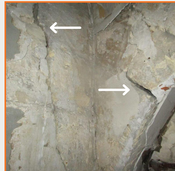
Fissures visibles dans les caves avant l'intervention
