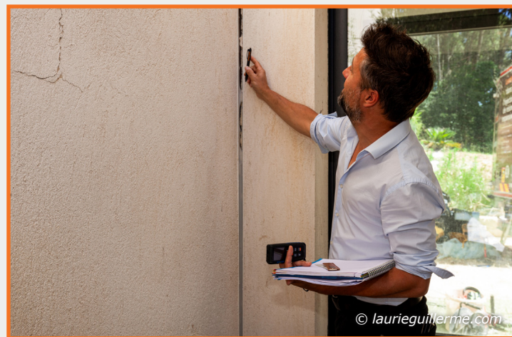
Analyse de la désolidarisation des 2 blocs de la maison par notre ingénieur d'affaires
