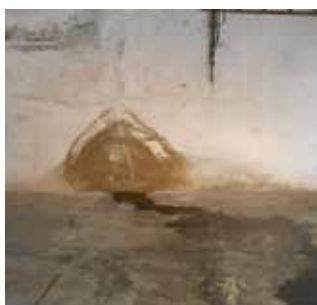
Un local touché par des infiltrations d'eau
