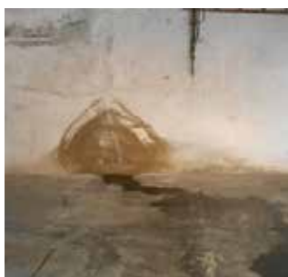
Un local touché par des infiltrations d'eau
